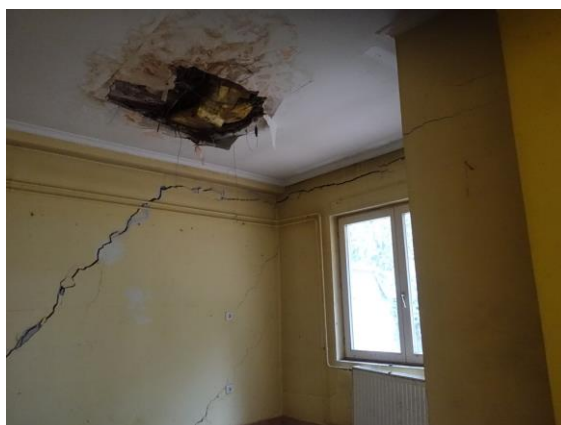
30. beszakadt födém, statikai probléma látható fele a tartófalon
