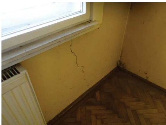
33. repedés a felmenő falazaton
