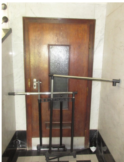
118.-120. A földszinti pihenő DNY-i oldalfalán elhelyezkedő tárolókba vezető ajtók – eredeti építéskori, történeti értékű nyílászárók
