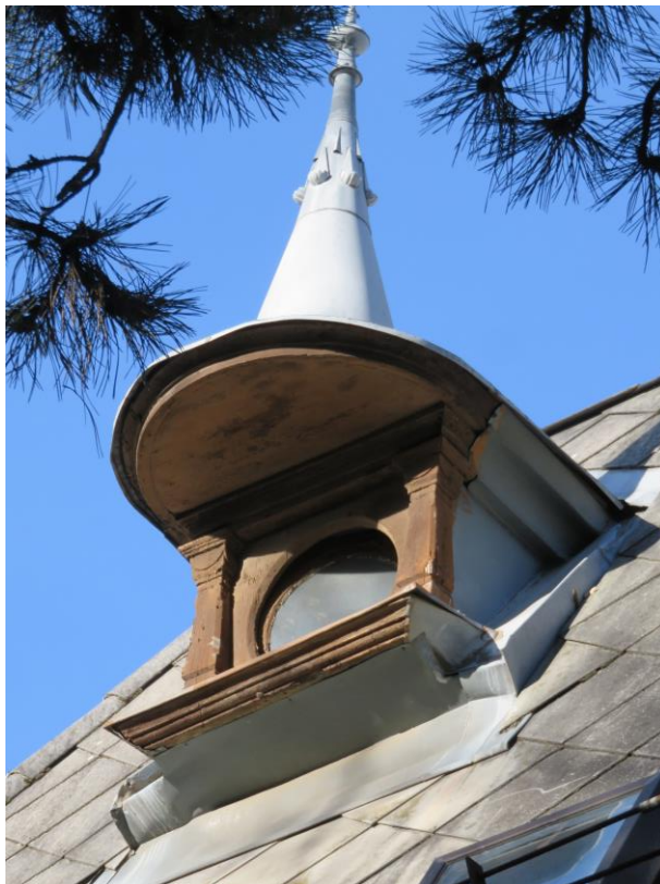
26. kép Padlásszellőző a délkeleti oldalon
