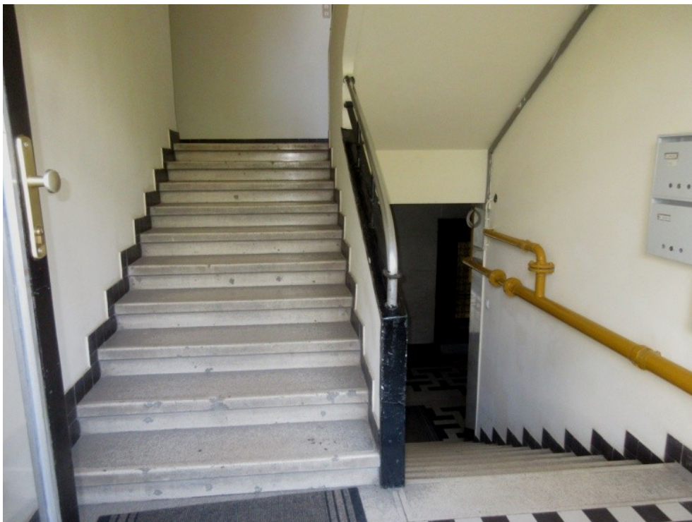
146. A földszintről az I. emeletre (magasföldszintre) haladó és érkező lépcsőkar – történeti értékű kialakítás és szerkezet
