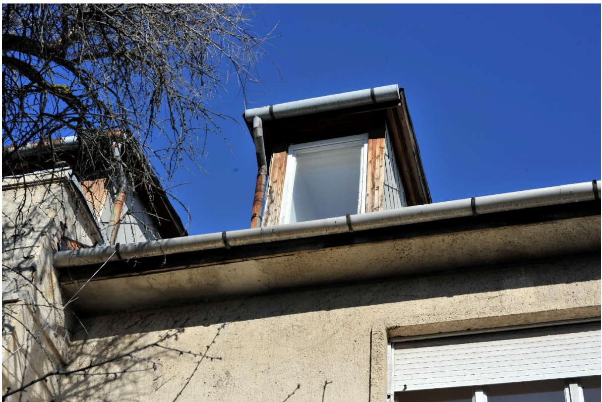
39. kép Utólagos tetőtérbeépítés tetőablaka a délnyugati homlokzat felett
