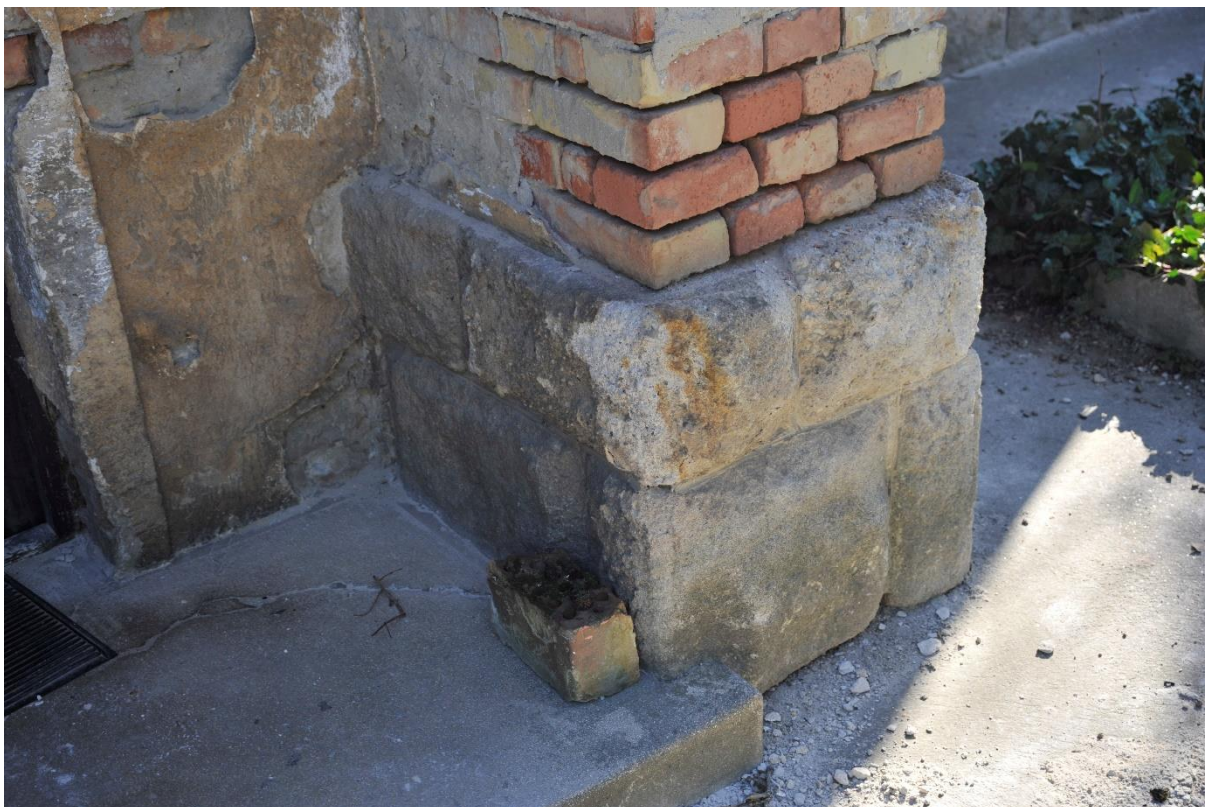
21. kép Mésző lábázat és lehullott vakolat az északnyugati homlokzaton a bejárat mellett
