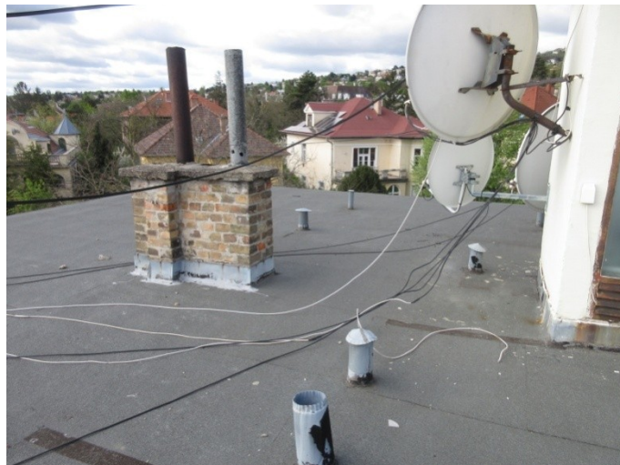
192.-196. A tetőfelépítmény és a lapostető nézetei - az épület eredetileg is lapostetővel készült, a tetőfelépítmény épülete eredeti építéskori szerkezet. A jelenlegi tetőszigetelés 2020-ban készült
