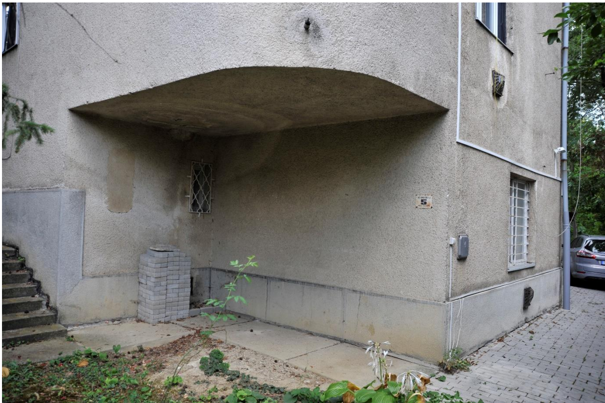
20. kép Az épület keleti sarka, alagsori szint / udvarszint
