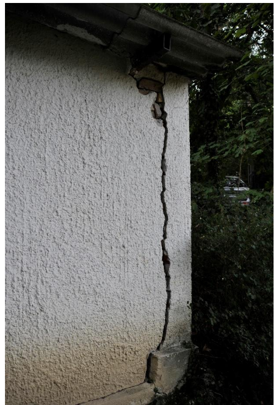
33. kép Repedés a garázs falán
