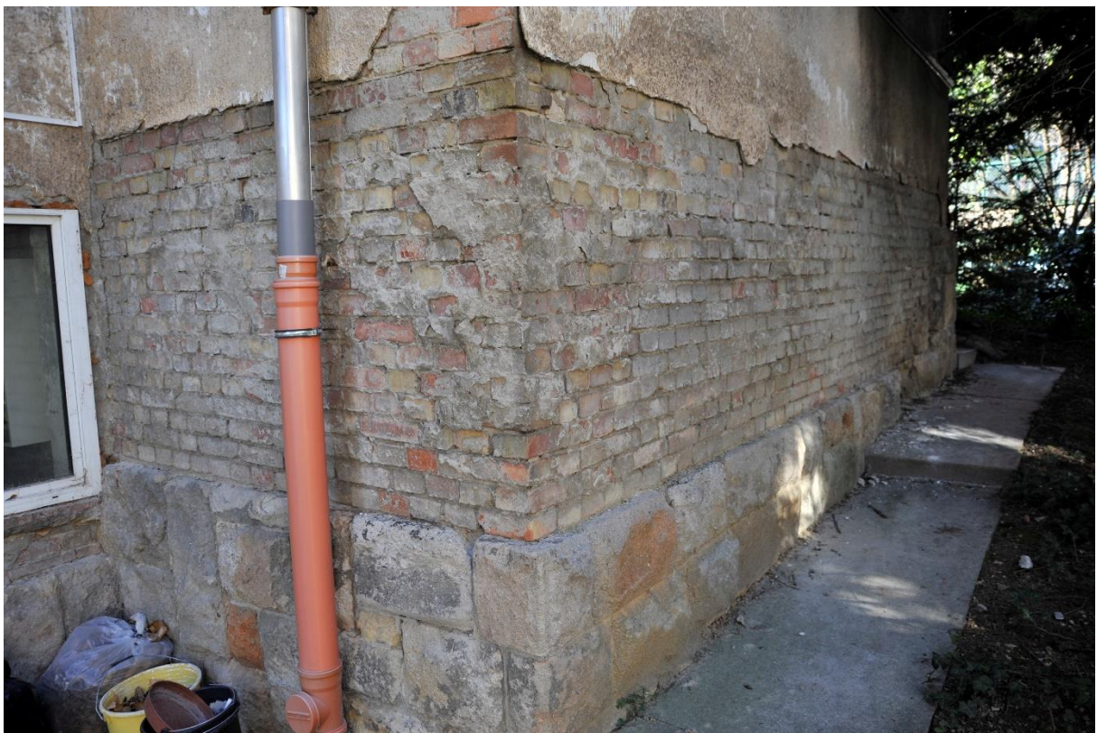
20. kép Vizededés és hulló vakolat az északkeleti homlokzaton
