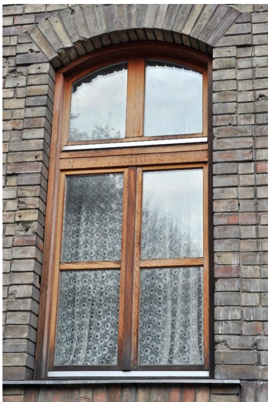
6. kép Főhomlokzat, földszint, cserélt, új ablak
