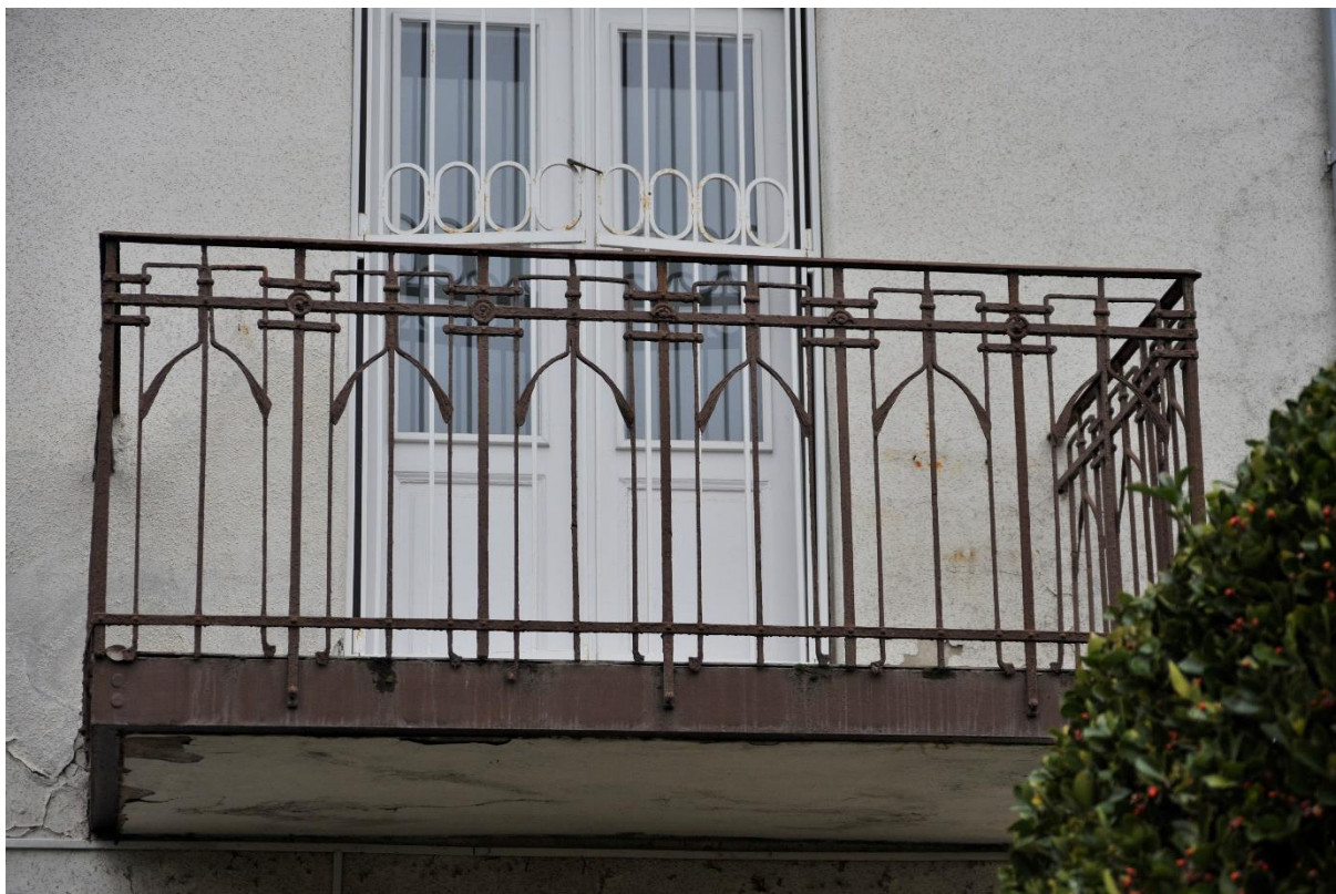
7. kép Keleti homlokzat, erkélykorlát
