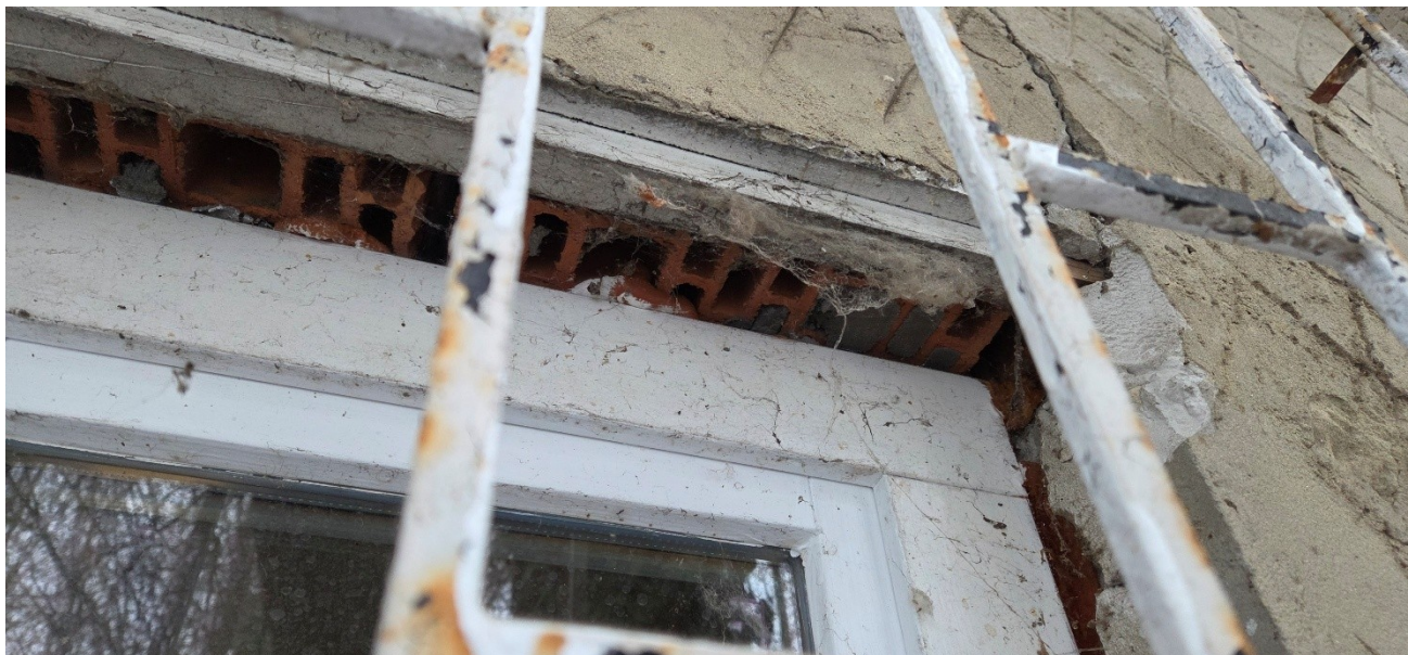
5/4. kép Utólagos elfalazás és szakszerűtlen nyílászáró beépítés
