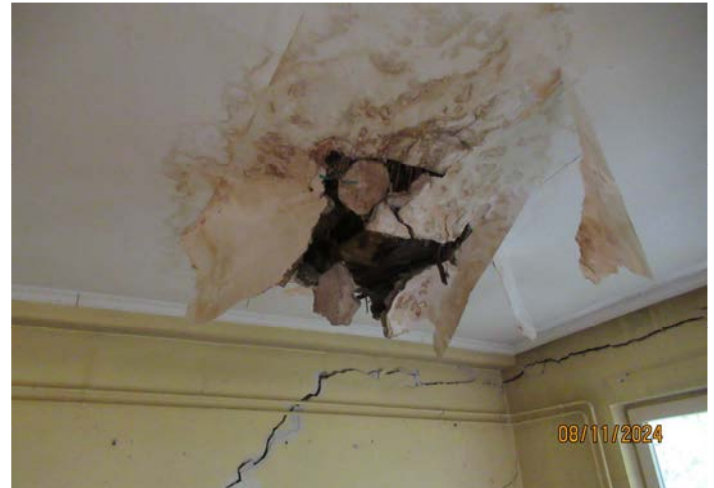
40 beázás, mennyezet beszaadás, repedések
