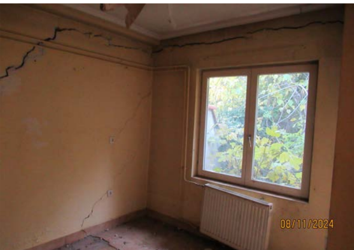
41 alapozási zavarra utaló repedések a falakon és földemen is
