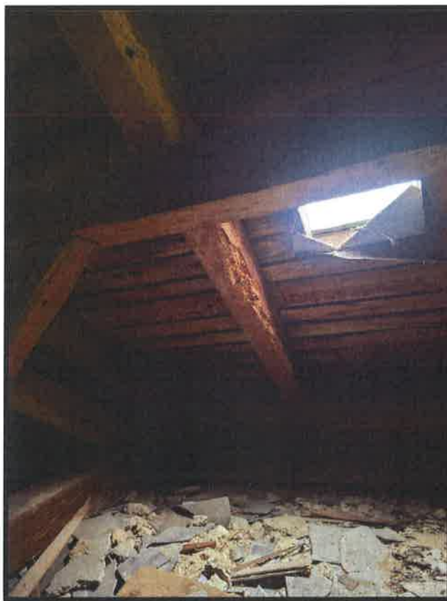
Bárdolással javítható tönkremenetel
