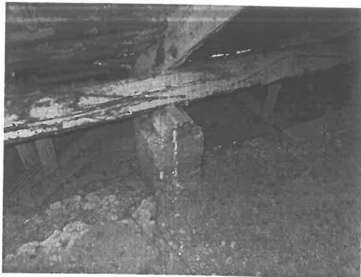
6. kép Talpszelemen és ereszdeszkázat felfüggesztése, szaru alsó végének károsodása a felfekvésnél.
