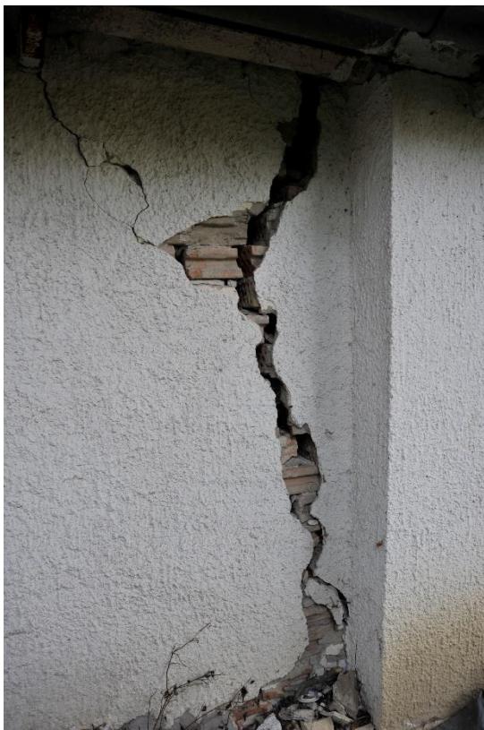
32. kép Repedés a garázs falán
