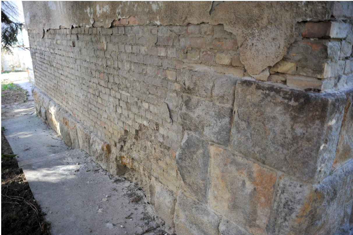
19. kép Vizededés és hulló vakolat az északkeleti homlokzaton
