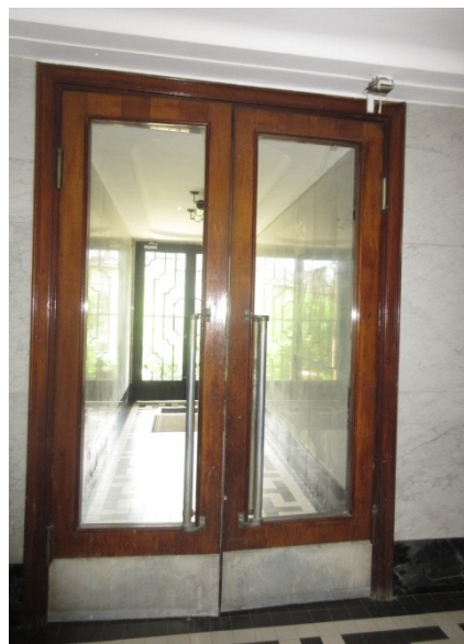
121.-124. A földszinti pihenő ÉK-i bejárati oldalfalának nézete, és a kapualji lengőajtó és a két lakásbejárati ajtó részlete – eredeti építéskori, történeti értékű nyílászárók
