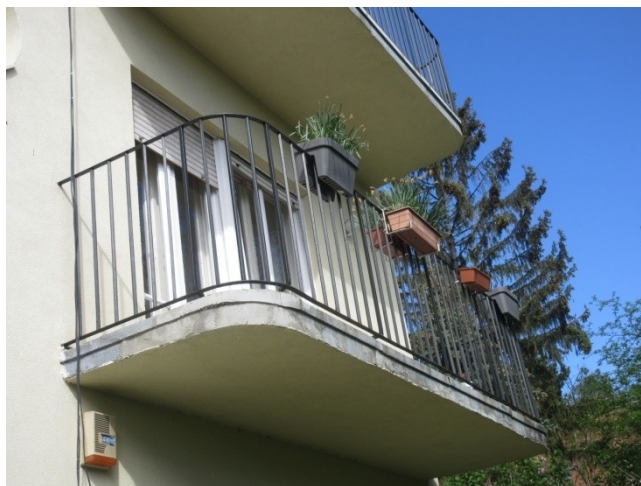
43.-46. A homlokzat jobb (É-i) oldali szakaszának I. emeleti részlete - a nyíláskiosztások és erkélyek építéskoriak. A páros-ablak tokkerete és nyílászárója új szerkezet. A körablak nyílászárója eredeti
