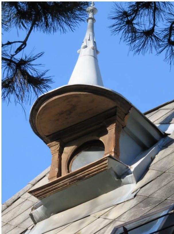
26. kép Padlásszellőző a délkeleti oldalon
