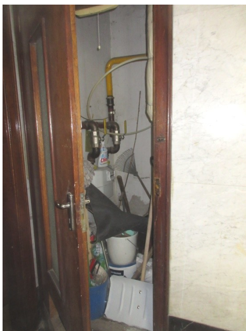
136.-138. A földszinti pihenő DK-i és ÉNy-i oldalfalán nyíló folyosók, amelyek a tárolókba vezetnek, valamint a DNy-i oldalfalon lévő tároló, ahol egykor a lakóház személyliftje volt – eredeti építéskori, történeti értékű kialakítás és nyílászárók, a DK-i folyosó burkolata új, az ÉNy-i részben eredeti
