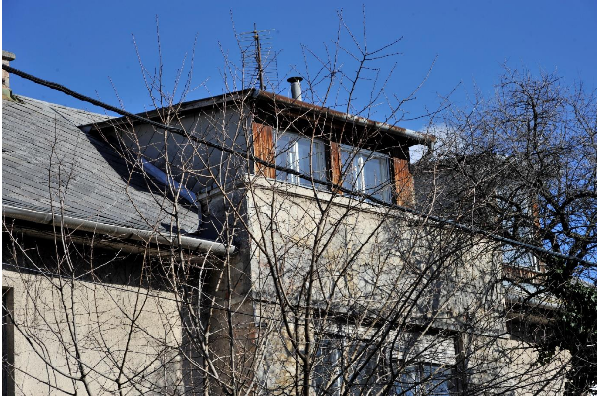
38. kép Utólagos tetőtérbeépítés tetőablaka a délnyugati homlokzat felett
