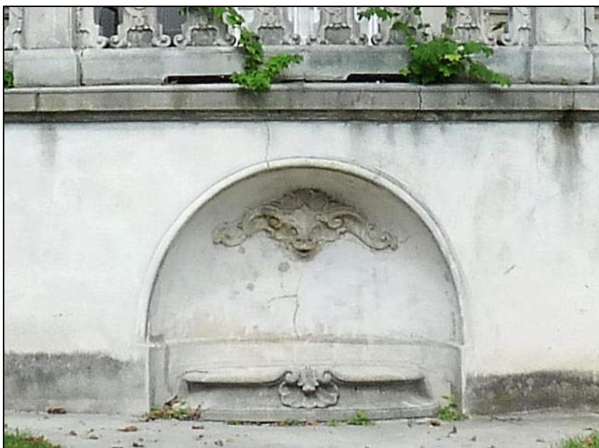
36. kép Déli homlokzat terasz alatti fülkében lévő szőkőkút, medence és kosfejes kőpórkút
