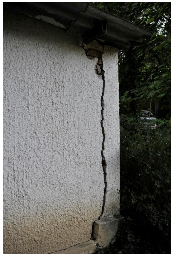
33. kép Repedés a garázs falán
