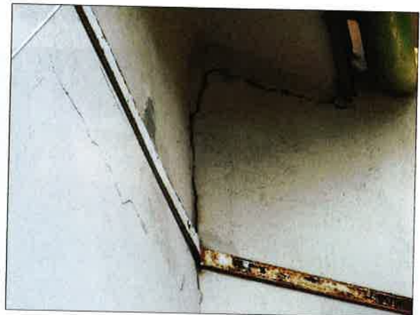
14. ábra Heveder és repedés a főpárkány alatt
