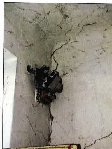
37. ábra Belső sarokrepedés
