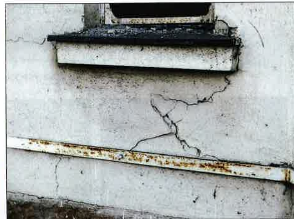
32. ábra Repedés a földszinti ablak alatt
