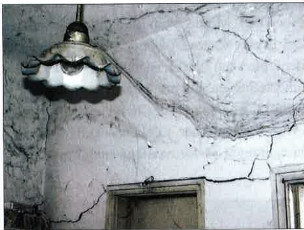
19. ábra Repedések a lakószobában
