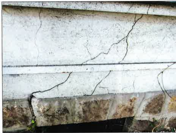
31. ábra Repedés a pinceablak felett
