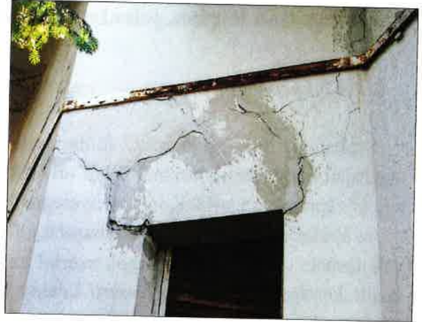
12. ábra Repedések a nyílászáró-áthidalás körül
