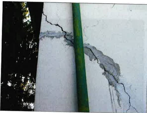
13. ábra Falrepedés az épületsarkon
