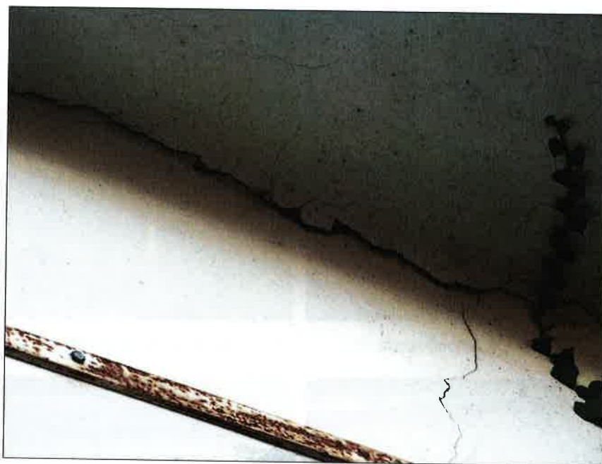
34. ábra Repedés a főpárkánynál
