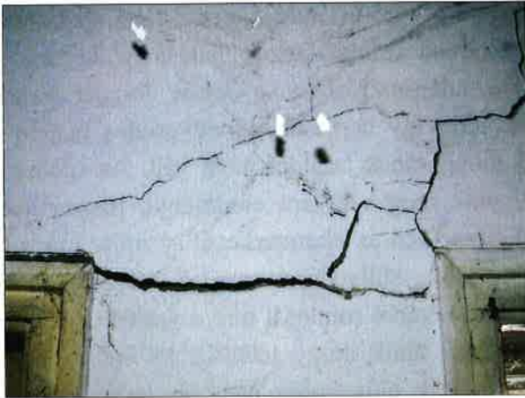
17. ábra Vízszintes repedés a belső főfalon
