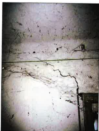
35. ábra Repedés belső ajtónál
