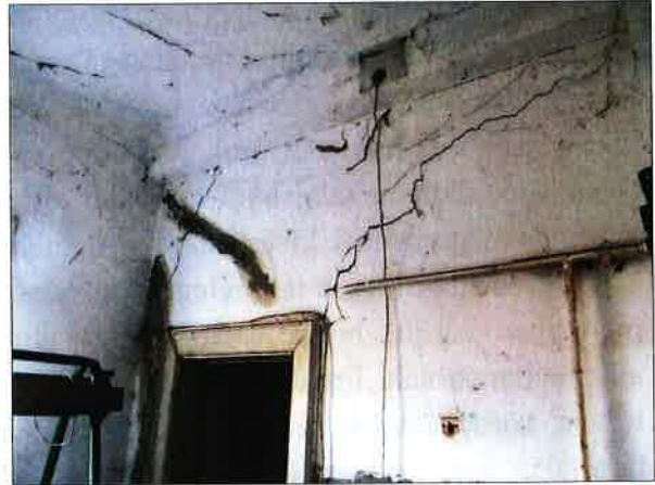
18. ábra Ferde repedés válaszfalon
