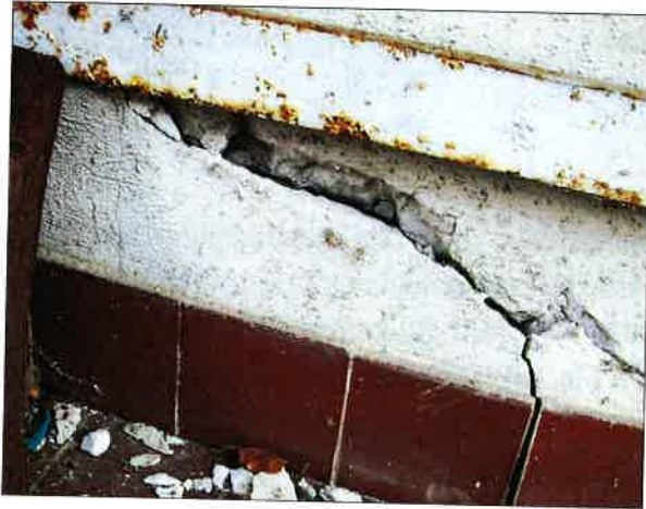
11. ábra Heveder és repedés a terasz lábazatánál
